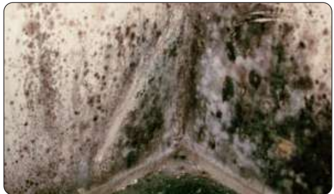
Foto N° 8 - Stachybotrys (Moho Negro) en muro de concreto en sótano inundado (Fuente : moldremediation.com)
