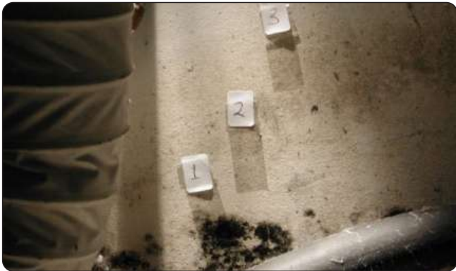
Foto N° 3 - Zona 1: Stachybotrys, Zona 2 : Cladosporium, Zona 3 : Aspergillus (Fuente : Inspectapedia.com)
