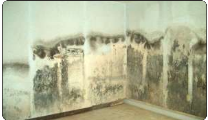
Foto N° 6 - Penicillium (Moho verde) en muro de drywall (Fuente : moldremediation.com)
