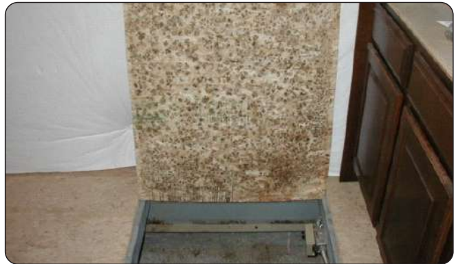
Foto N° 4 - Cladosporium en tapa de cisterna (Fuente : Inspectapedia.com)
