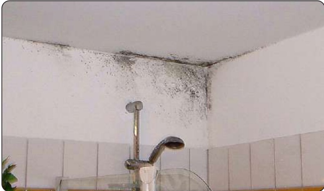
Foto N° 5 - Cladosporium en muro y techo de cocina (Fuente : moldremediation.com)
