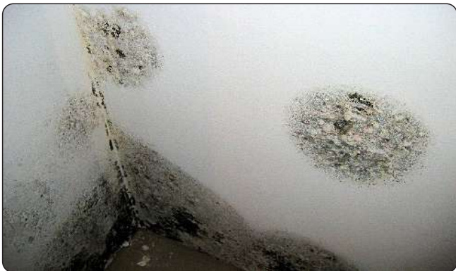
Foto N° 9 - Stachybotrys (Moho Negro) en muro de drywall con alta condensación (Fuente : www.timberwisw.co.uk)
