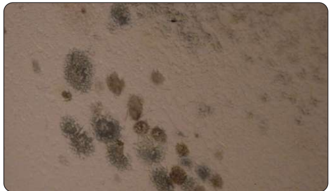
Foto N° 10 - Penicillium (Moho verde) en muro poroso (Fuente : www.mold-help.org)
