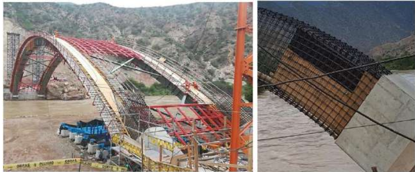
(a) (b) Figura 18: Arranques del puente en construcción. (a) Vista global (b) Vista de un arranque
